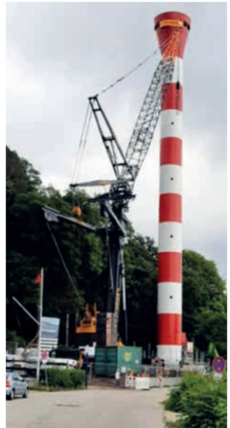
Das neue Oberfeuer am Mühlenberger Jollenhafen wird aufgerichtet (Foto: Regina Harten)
