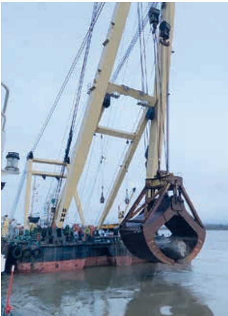
Schwimmkran ENAK mit dem im Wasser geborgenen Findling (Foto: Lührs Schifffahrts-GmbH & Co)
