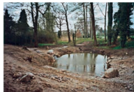
Bild 7. An der verschollenen „Almhütte“ sollte wenigstens der (fünfte) Teich wieder an die vergangenen Zeiten erinnern. 2006 wurde deshalb für ihn ebenfalls ein neues Bett bereitet. Auch der kleine Wasserfall wurde wieder nachempfunden (hinten). Der Zufluss blieb links, der Abfluss rechts, wie früher, nur nicht mehr in der alten Menge. Auf der Alm, da gab's (wahrscheinlich) „kei Sünd“ (doch das ist wieder die andere Geschichte), im Teich gibt's jetzt kein Wasser mehr (Bild 8).
