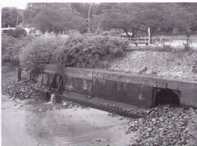
Bild 2: Leise plätschern die Reste von Flott- und Teufelsbek in den Teufelsbrücker Hafen (links). Die erheblich größere Ausmündung rechts ist seit langem bedeutungslos: Ein altes Stammsieles der Stadtentwässerung.
